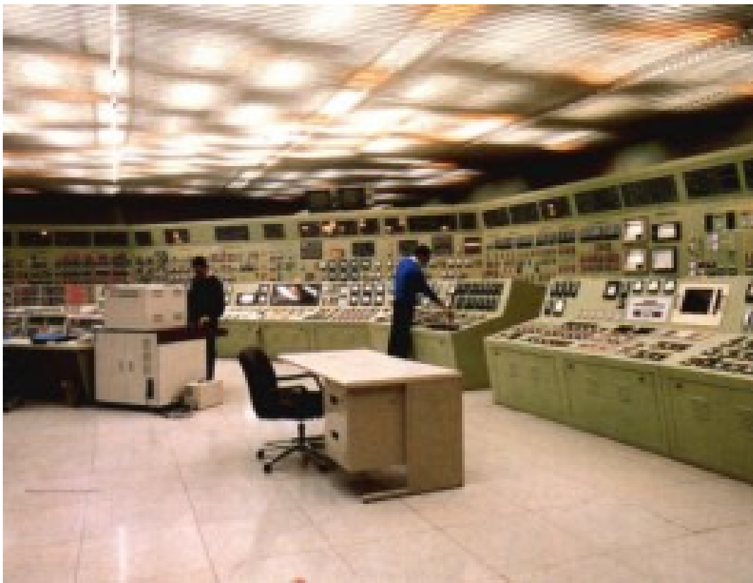
Sala de comando de uma Usina Nuclear
