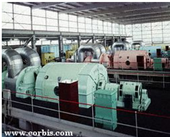
Turbo geradores de uma central nuclear
